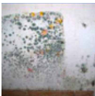
Contaminations fongiques sur un mur
