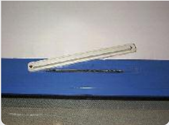
Photo 7 : Entrée d'air avec réservation trop étroite
