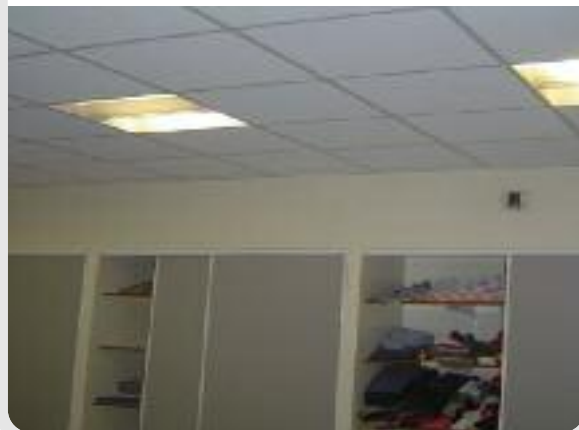
Photo 13 : Bouches d'extraction d'air dans un dortoir
