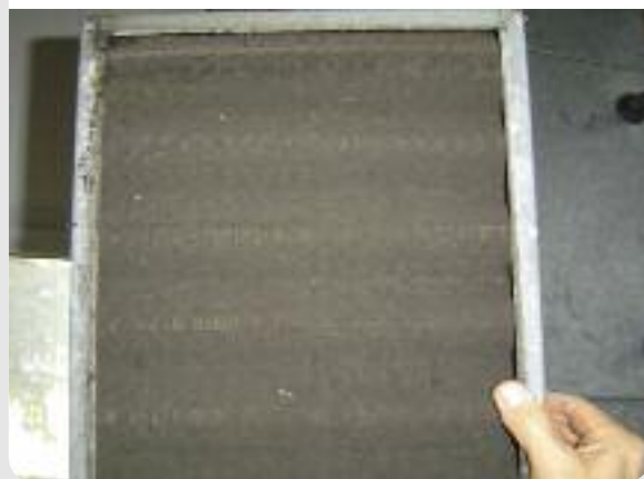
Photo 15 : Filtre de CTA très encrassé
