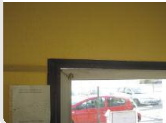
Photo 14 : Porte-fenêtre non étanche à l'air (jour visible)
