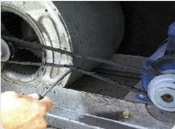
Photo 3 : Courroie ventilateur en mauvais état
