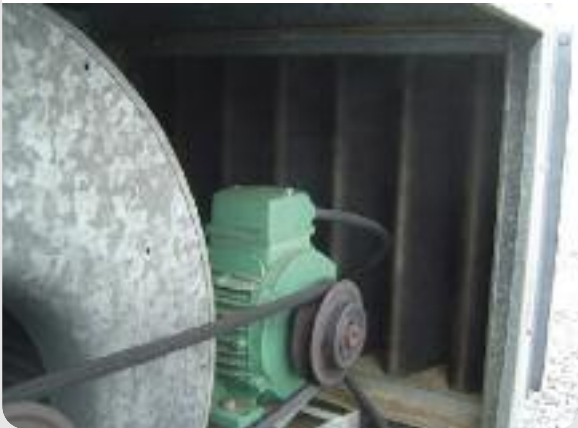
Photo 4 : Intérieur CTA avec filtre à air
