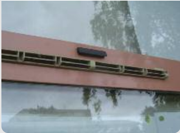
Photo 8 : Entrée d'air dans une fenêtre
