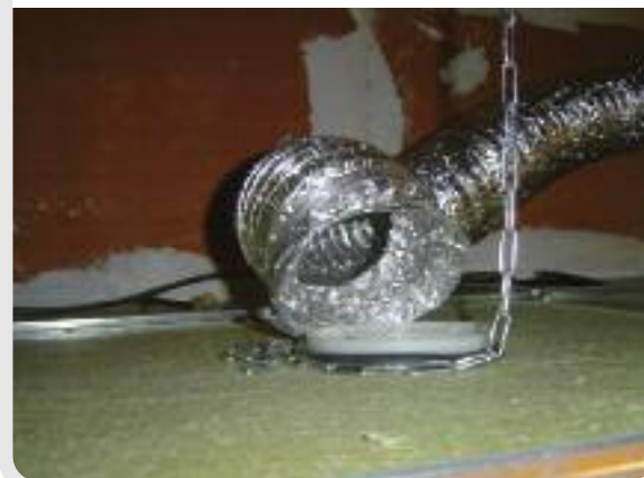
Photo 12 : Bouche déconnectée au-dessus du plafond
