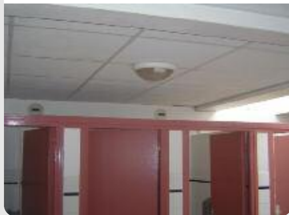
Photo 11 : Bouches d'extraction dans des sanitaires
